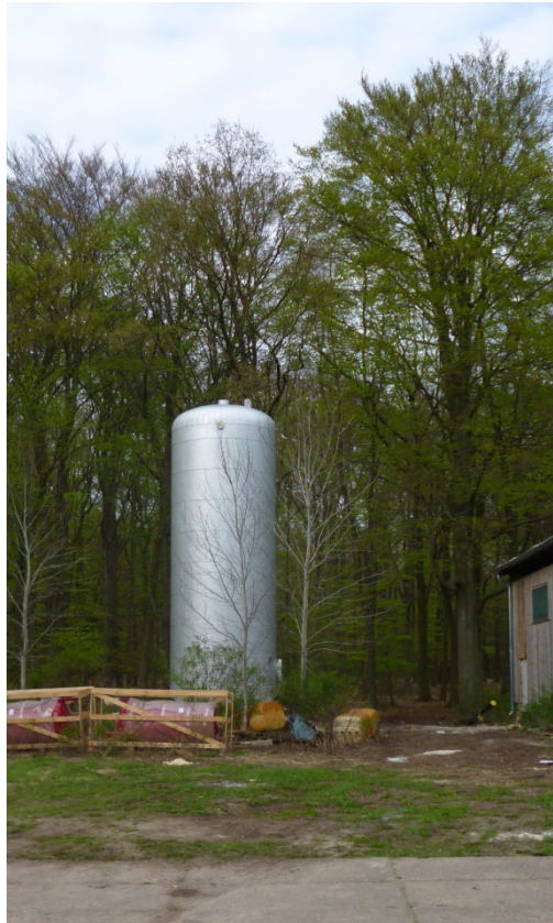
Pufferspeicher direkt am Wald
